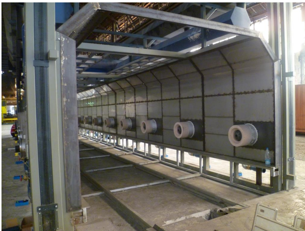
Fig. 27. Four avant revêtement.
