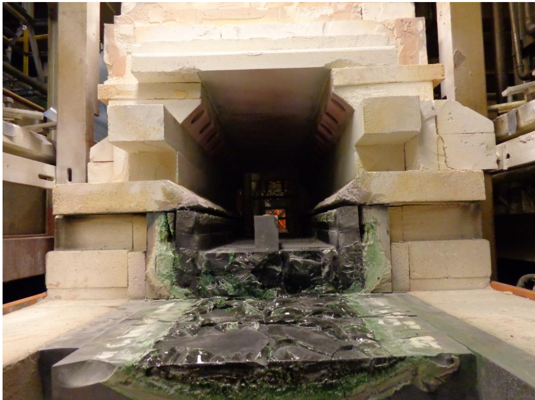
Fig. 17. Canal de coulée endommagé.
