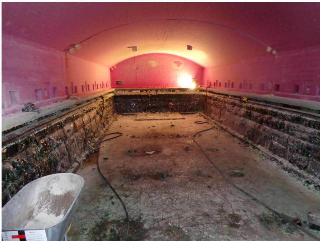
Fig. 21. La couche de verre a été totalement évacuée.
