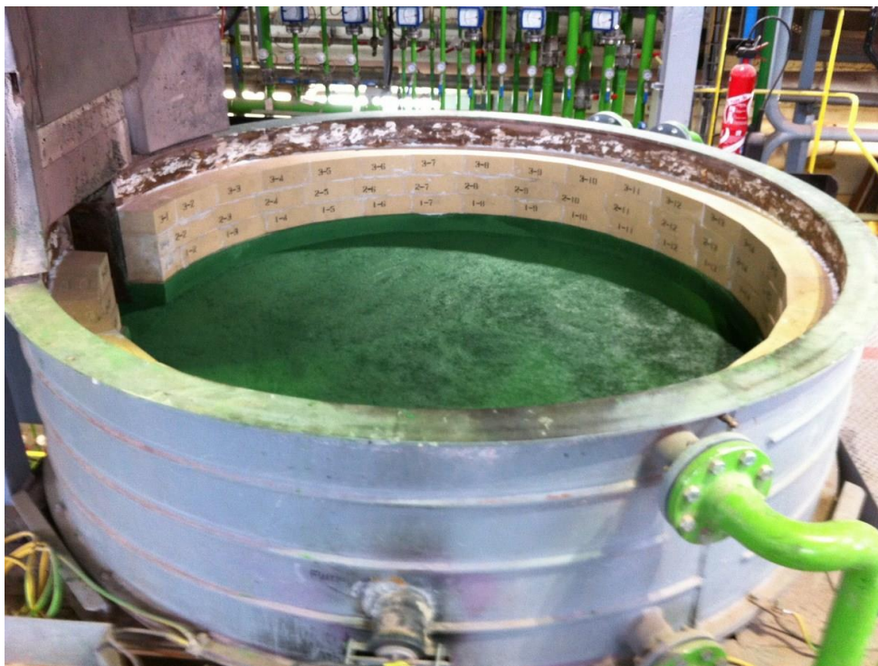
Fig. 23. Briquetage en verrerie (la zone verte correspond à un mortier contenant du chrome).
